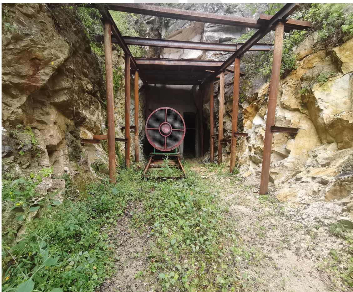
图 2.4-7 主通风机现状
